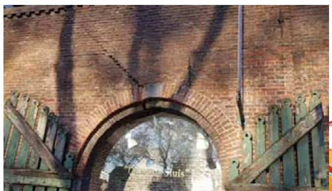
Foto Marja van Eijk van de gevel en de breuk.
